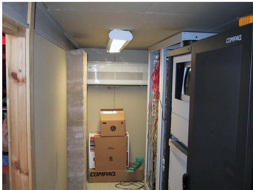
Figur 2. Serverrummets fordamper og rack.
