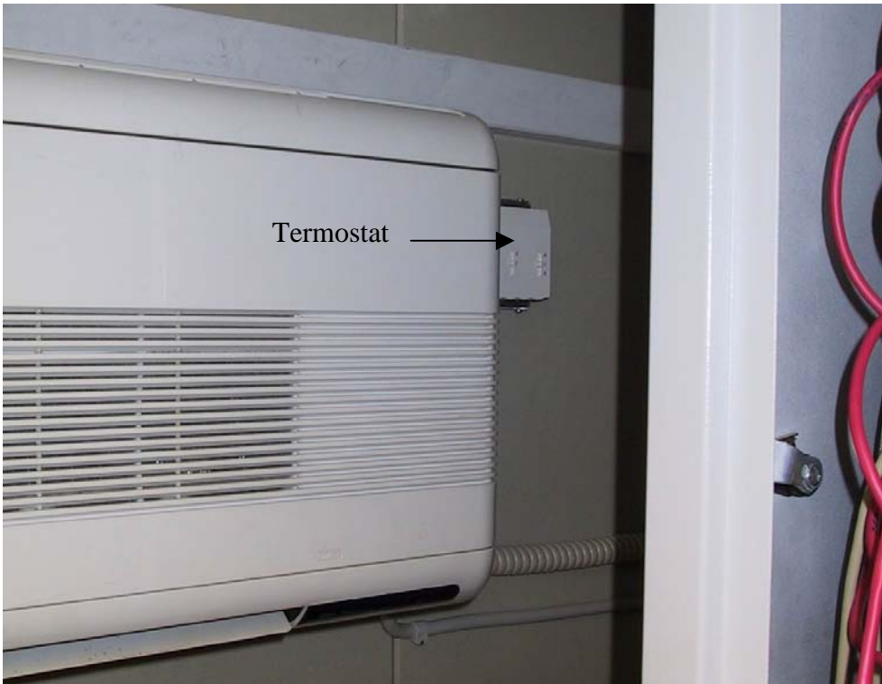
Figur 4: Køleanlæggets indedel og termostat
